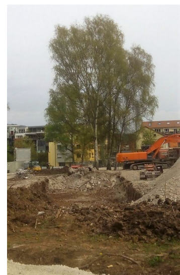
Fehlende Baukontrollen auf Baufeld (Foto: B. Lupp)
